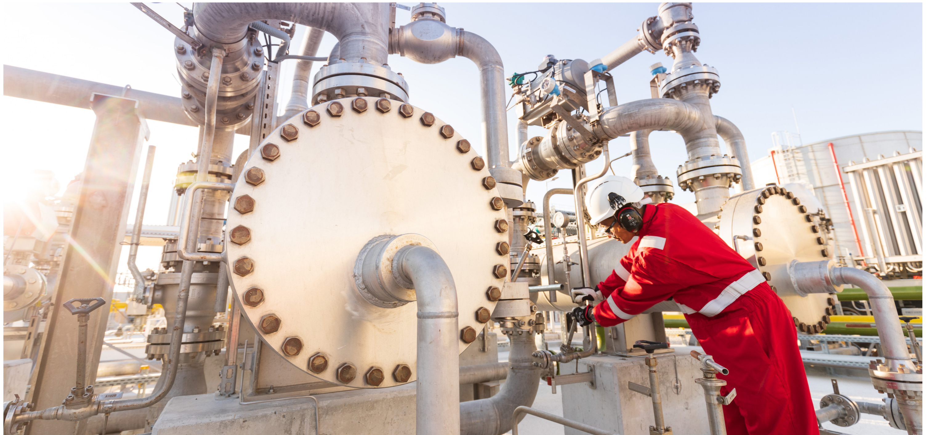
Gibraltar LNG Regasification Terminal – Courtesy of Shell
