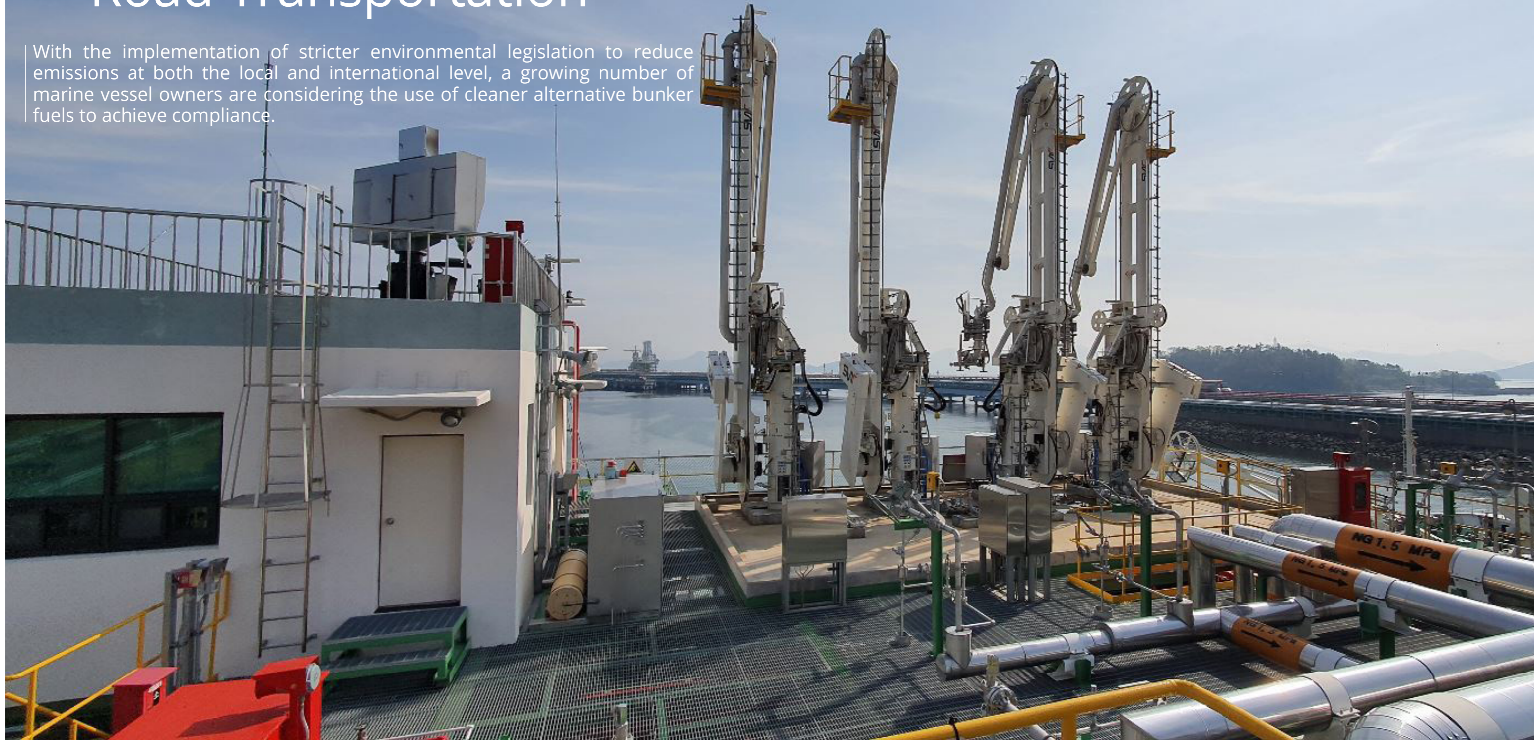
Incheon LNG Terminal - Courtesy of KOGAS
