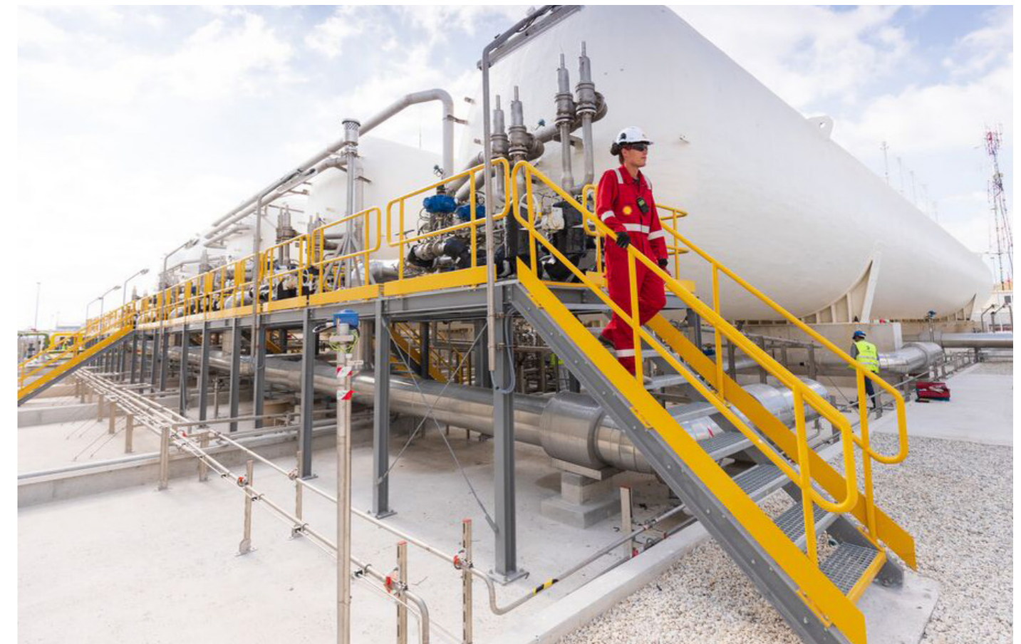
Gibraltar LNG Regasification Terminal – Courtesy of Shell
